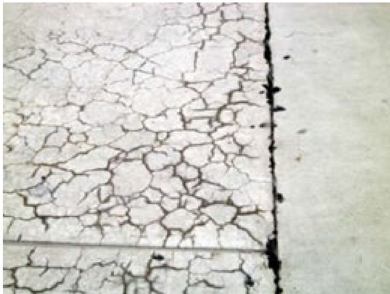
Abb. 3.2 Makrorisse im einem Betonbauteil durch Alkalitreiben /PAP 21/
