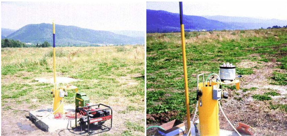
Abb. 2.5.1: Grundwassermessstelle NA4; links: Aggregat und Kompressor zum Betrieb der Bladder-Pumpe; rechts: isolierte Durchflusszelle zur Messung der „On-site-Parameter“ Temperatur, Leitfähigkeit, pH-Wert und Redox
