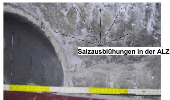
Abb. 6.10 (links): Salzausblühungen am Streckenstoß (Auflockerungszone).
