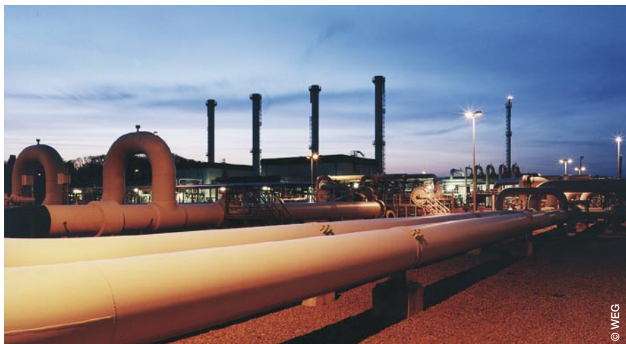
▲ Größter europäischer Erdgasspeicher „Rehden“ Largest European Natural Gas Storage Facility “Rehden”
