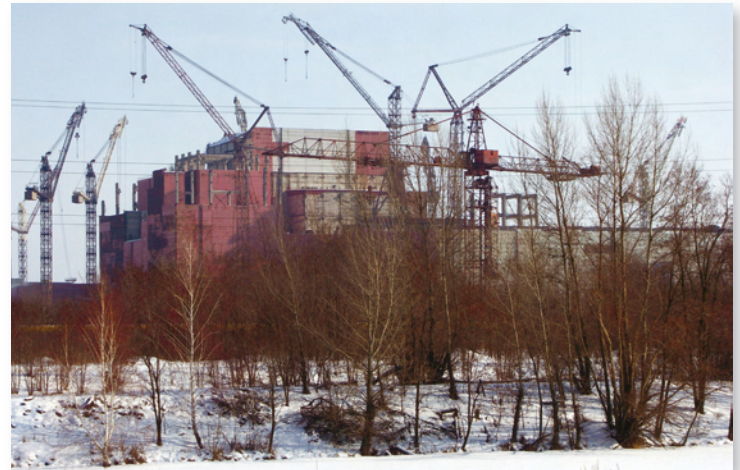
▲ Nach dem Unfall verlassene Baustelle der Blöcke 5 und 6 Building site of Units 5 and 6, abandoned after the accident
