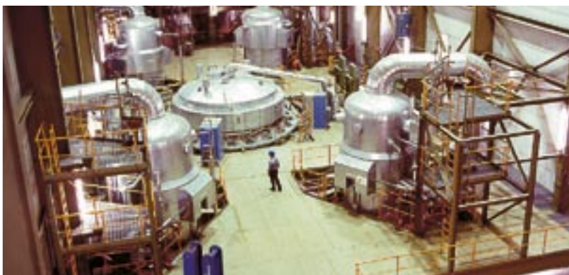
Reaktordruckbehälter und vier Dampferzeuger der UPTF
