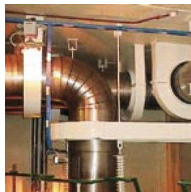
Frischdampfleitungen im Containment
