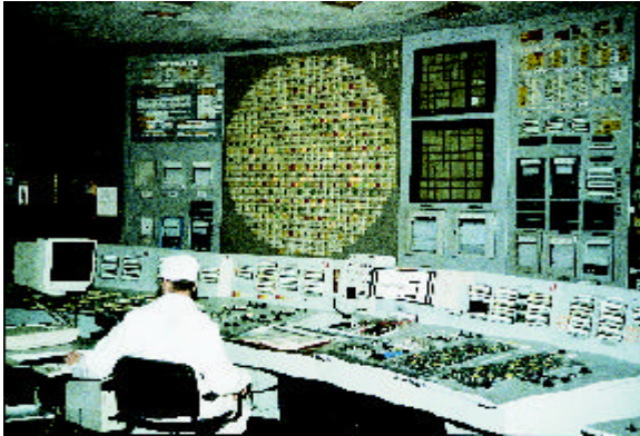
Warte im Kernkraftwerk Tschernobyl
