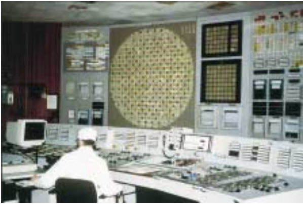
◀ Warte im Kernkraftwerk Tschernobyl
