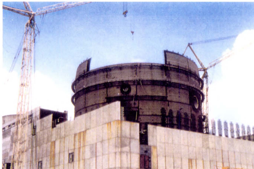
Bild 5.2: Fast fertiggestelltes zylindrisches Containment mit dem umgebenden Reaktorgebäude des Kernkraftwerks Stendal Anfang 1991
