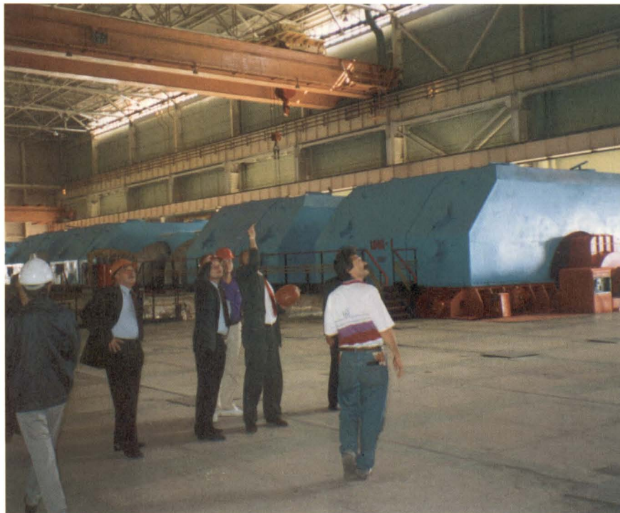
Bild 4.9: Turbinenhalle des Blockes 3 mit WWER-1000
