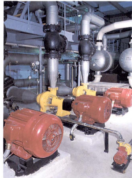
Bild 4.13: KKW Kozloduy, Block1, Raum für die Notkühlpumpen. Zu sehen sind drei der sechs neu installierten Notkühlpumpen ZN-65, die die leistungsschwächeren NP-50-Pumpen ersetzen, im Hintergrund die Wärmetauscher des Gebäudesprühsystems
