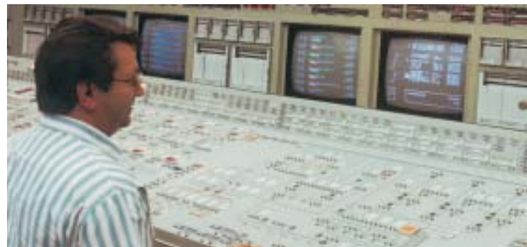
Das Kernkraftwerk Grohnde: die Warte mit analoger und digitaler Leittechnik
