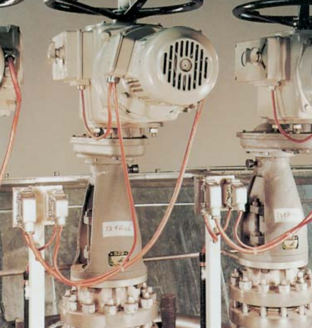
Ventile, wie sie im Kernkraftwerk zum Einsatz kommen. Sie können wahlweise per Motor oder mit einem Handrad geöffnet bzw. geschlossen werden.
