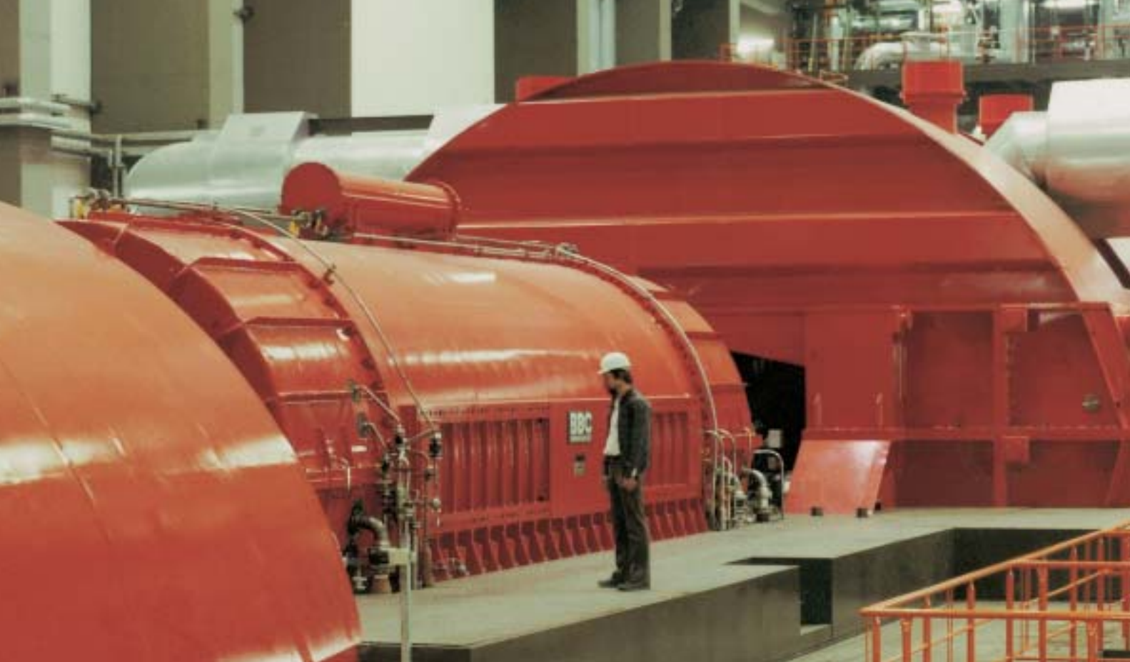
Generator (vorn) und Turbine (hinten) in einem Kernkraftwerk
