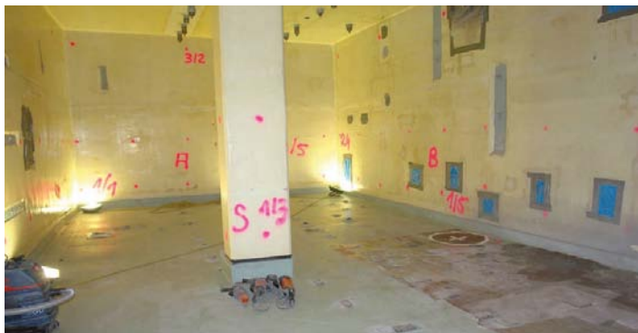
Abb. 35: Raum mit Markierungen zur Bestimmung der Oberflächenkontamination
