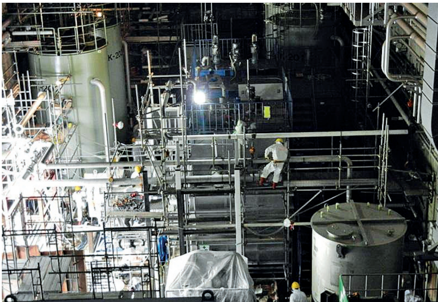
Abb. 6.5: Blick in die Wasseraufbereitungsanlage (Quelle: TEPCO).
