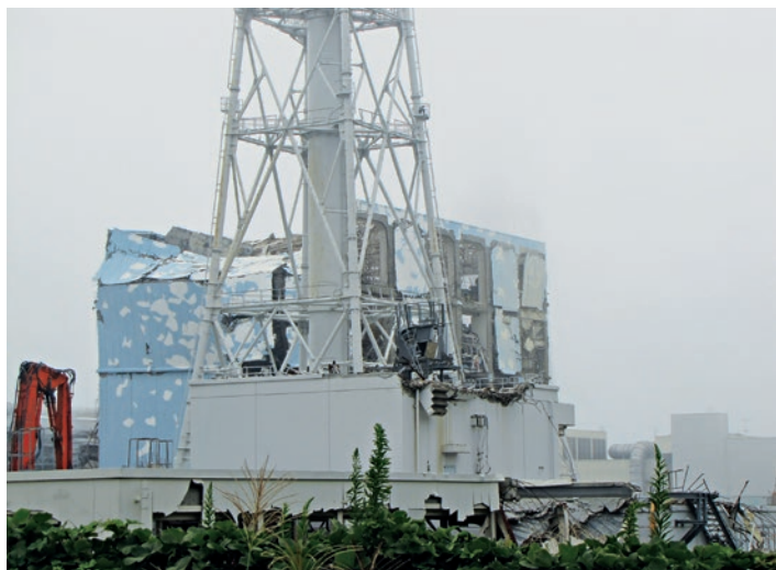
Abb. 3.29: Der durch eine Explosion stark beschädigte Block 4 (Quelle: TEPCO).
