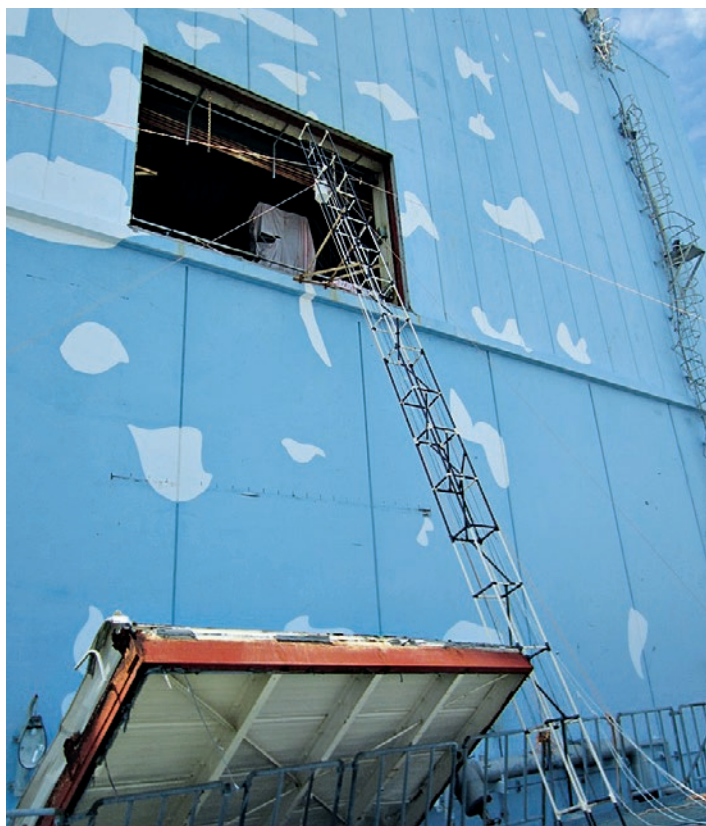
Abb. 3.20: Öffnung im Reaktorgebäude 2 (sog. »blowout panel«), die möglicherweise eine Ansammlung von Wasserstoff und damit eine Explosion verhindert hat (Quelle: TEPCO).
