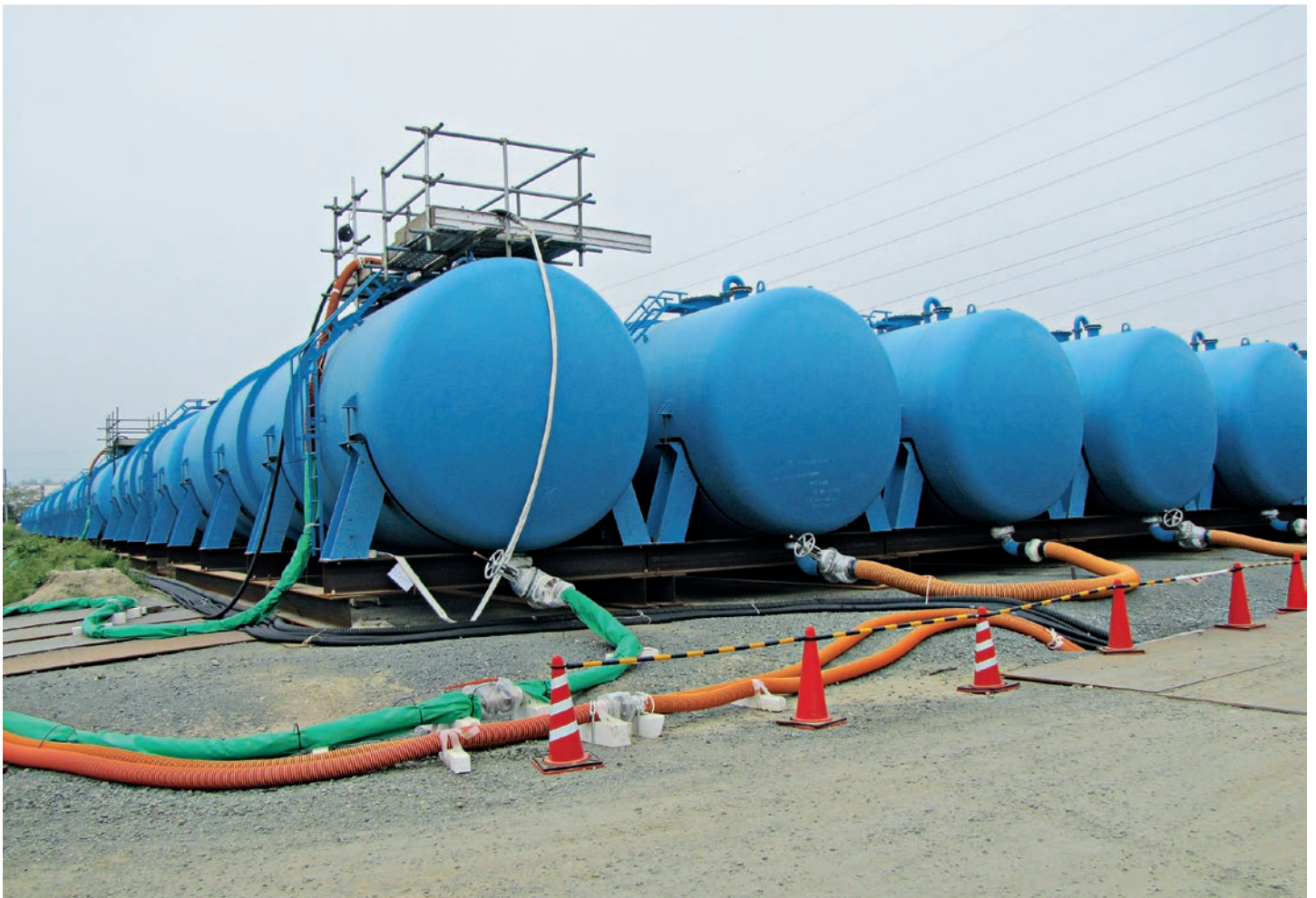
Abb. 6.6: Tanks zur Lagerung von kontaminiertem Wasser (100 t) (Quelle: TEPCO).
