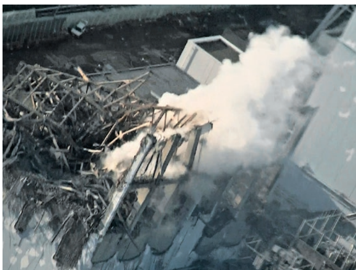
Abb. 3.25: Blick auf die Zerstörungen von Block 3 vom Hubschrauber aus (Quelle: TEPCO).
