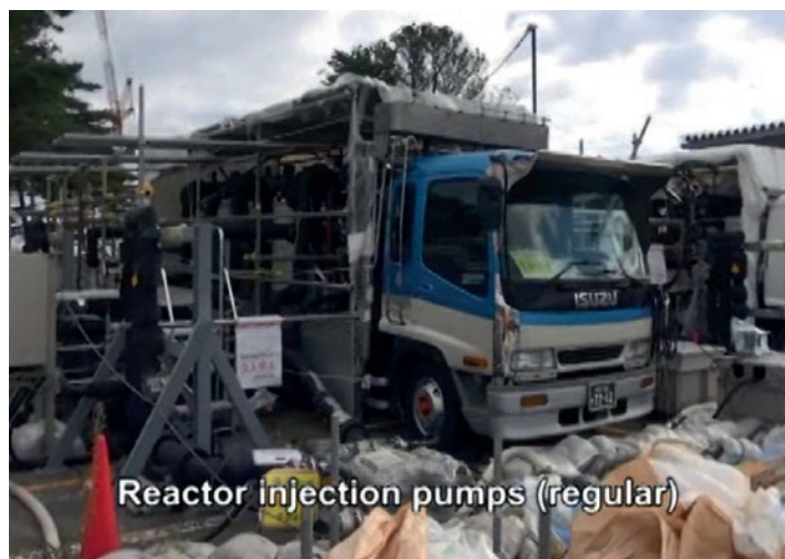
Abb. 6.1: Reaktoreinspeisepumpen und Ersatzaggregate (Quelle: TEPCO Video).
