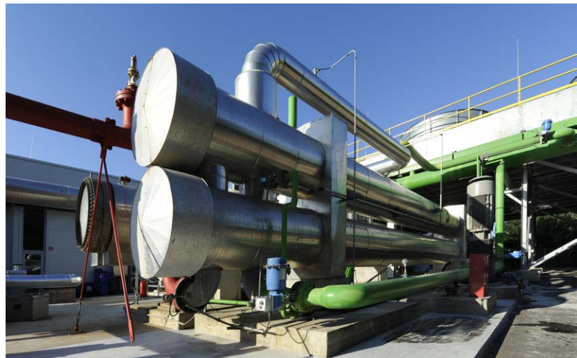
Vorheiz- und Verdampfer (Foto: geo x GmbH)
