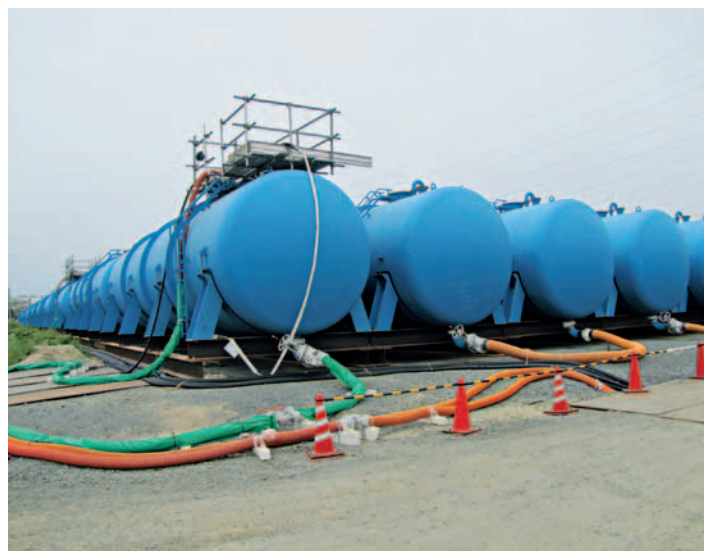
Abb. 6.4: Tanks der Wasseraufbereitungsanlage (Quelle: TEPCO).
