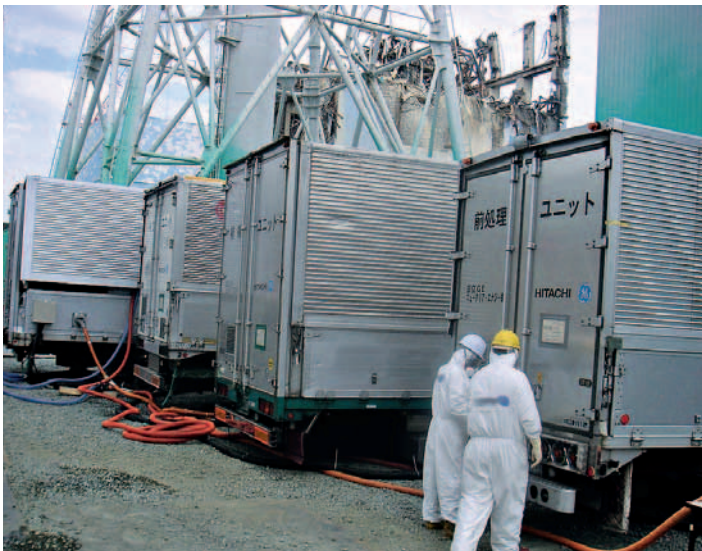
Abb. 6.1: Mobile Anlagen zur Entsalzung des Wassers in den Brennelementbecken (Quelle: TEPCO).
