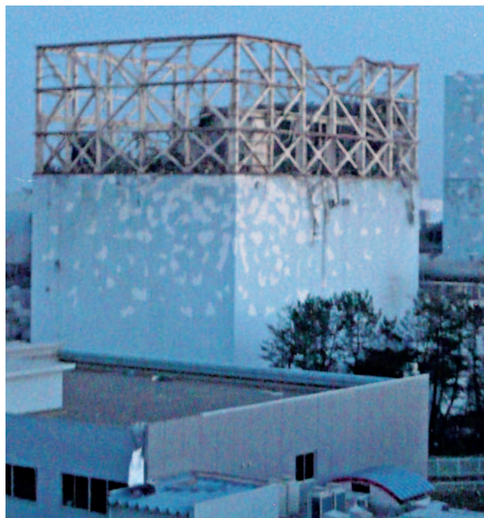
Abb. 3.14: Reaktorgebäude des Blocks 1 nach der Explosion am 13. März 2011 (Quelle: TEPCO).
