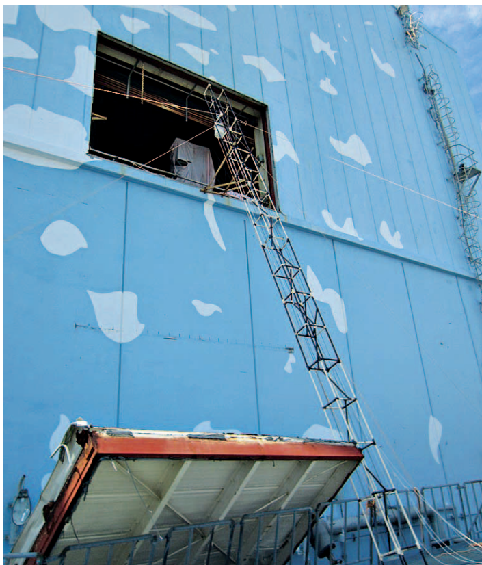
Abb. 3.20: Öffnung im Reaktorgebäude 2 (sog. »blowout panel«), die möglicherweise eine Ansammlung von Wasserstoff und damit eine Explosion verhindert hat (Quelle: Tepco).
