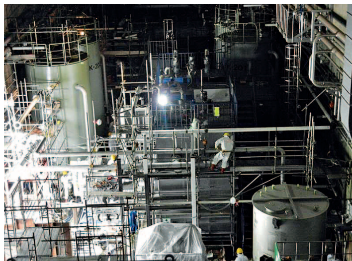
Abb. 6.5: Blick in die Wasseraufbereitungsanlage (Quelle: TEPCO).
