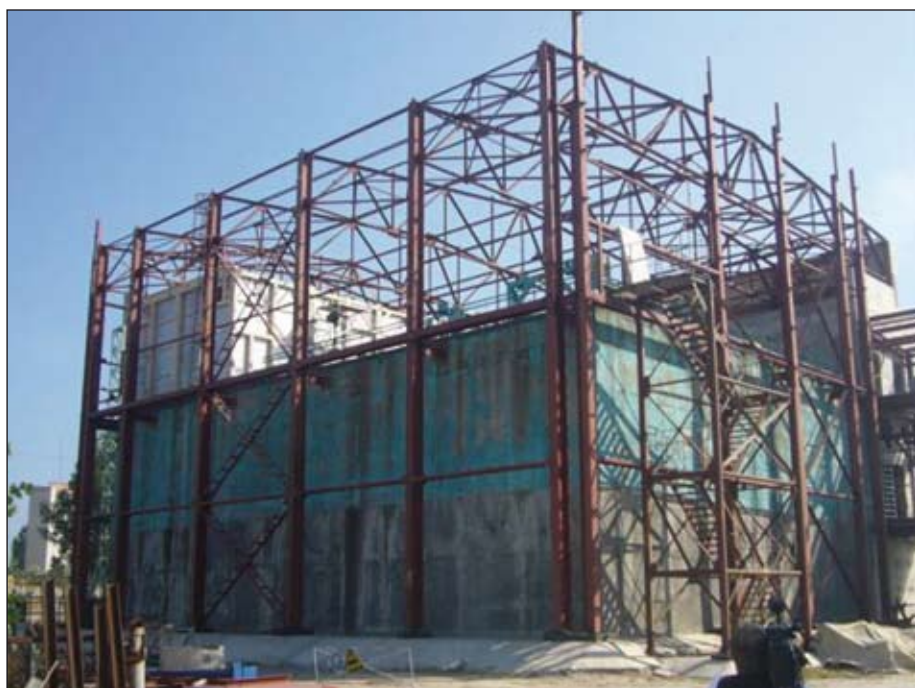
Abb. 5: Anlage zur Rückholung der festen Abfälle ICSRM über dem Betonbunker
