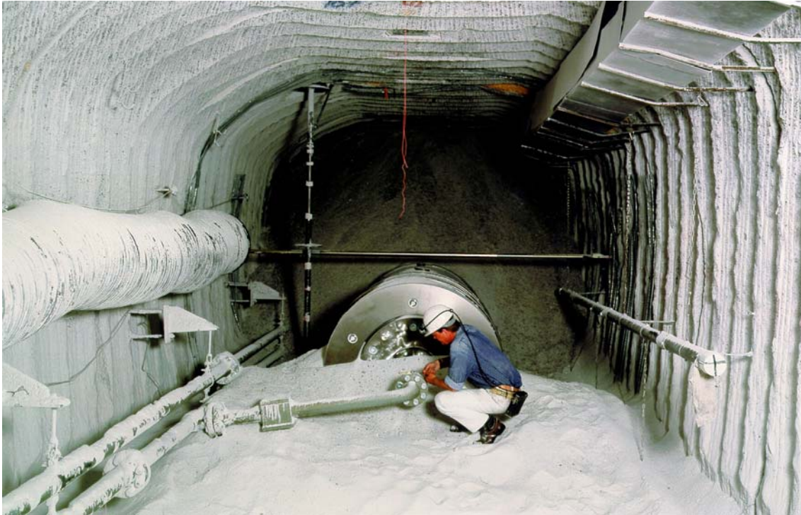
Abb. 42 TSS-Versuchsfeld: teilversetzte Versuchsstrecke mit Behälteratrasse und installierter Messinstrumentierung (Quelle: DBE)
