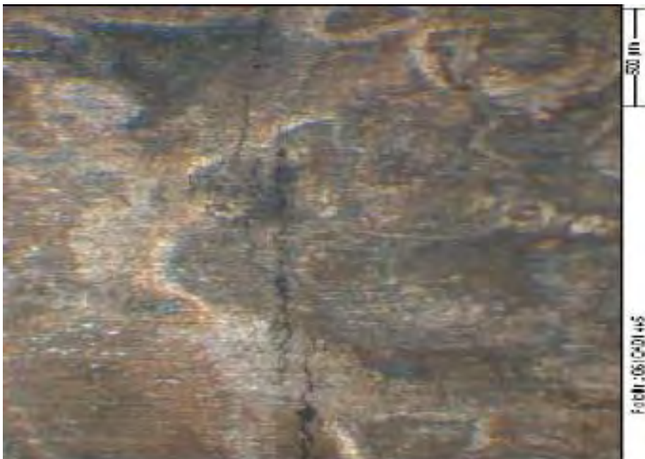
Bild 3.26: Kernkraftwerk Biblis A: Rissbefund auf der Außenoberfläche eines Dampferzeuger-Heizrohres
