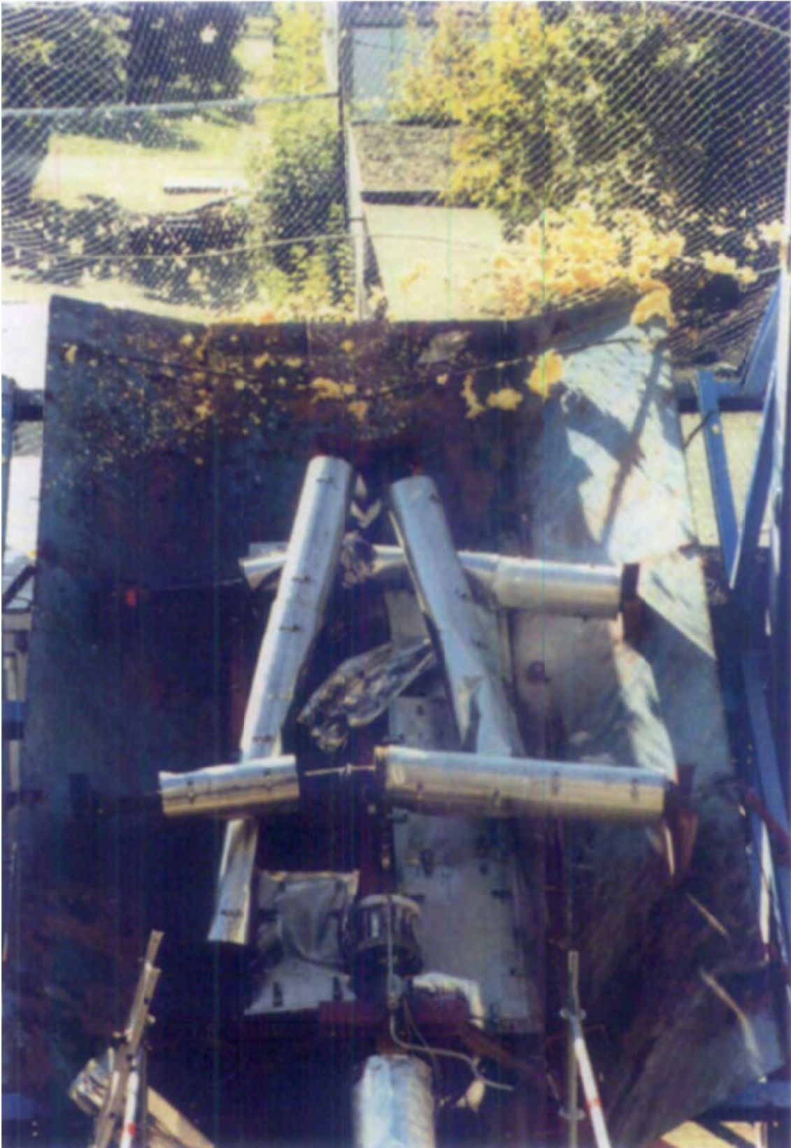
Abb. 4-1 Zerstellungsgrad der Kassettenisolierung bei Versuch K3 / KAE95/
