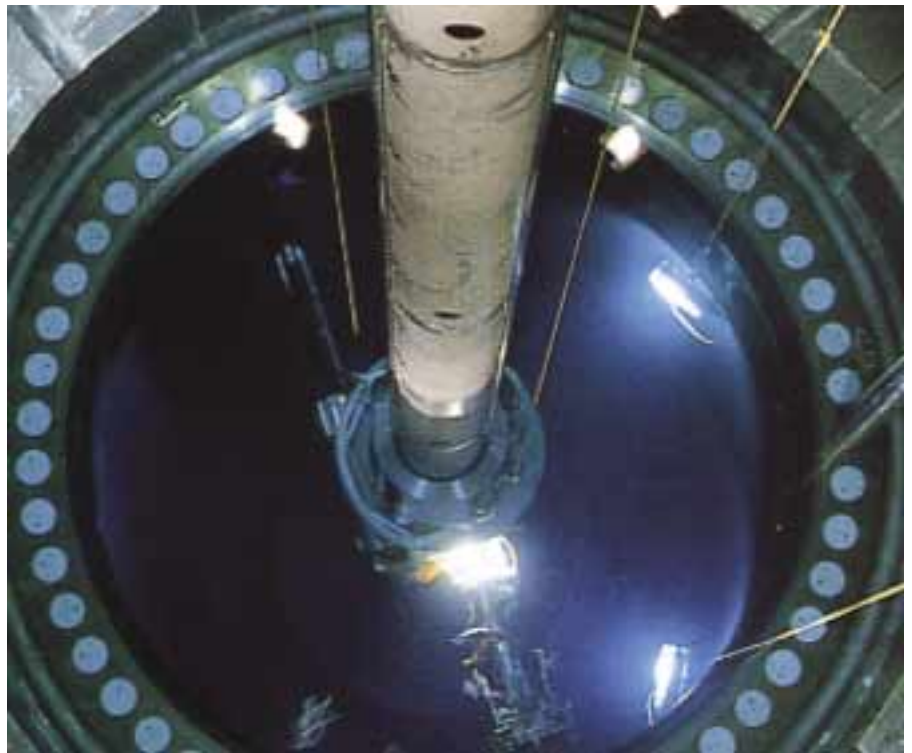
Blick in den geöffneten Reaktordruckbehälter mit Brennelementwechsellmaschine
