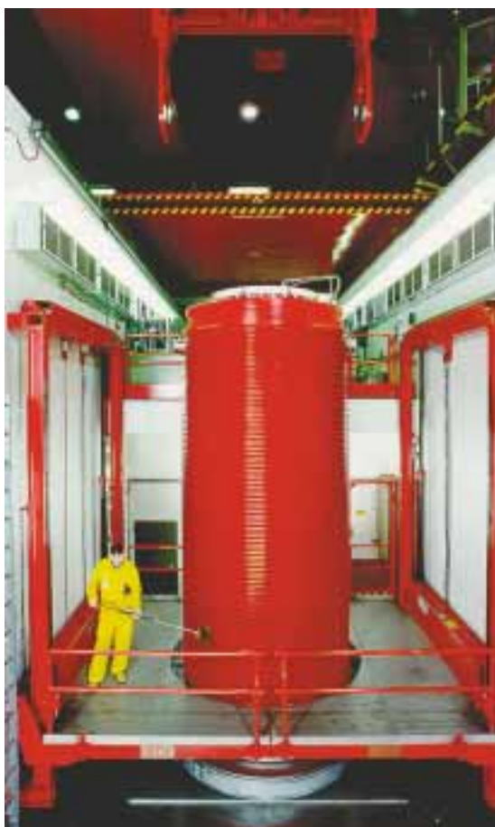
Am 25. April 1995 begann die externe Zwischenlagerung im Brennelementlager Gorleben: im Wartungsraum ein Transport- und Lagerbehälter für Glaskokillen vom Typ CASTOR HAW 20/28
